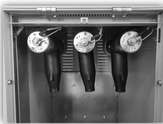
Rys.6.8. Złącza typu C z przekładnikami napięciowymi małej mocy (przykład)
